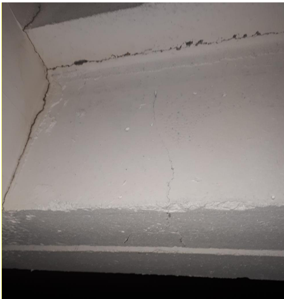
Сквозная трещина в балке покрытия техэтажа 3 подъезда образовавшаяся на январь 2021.
