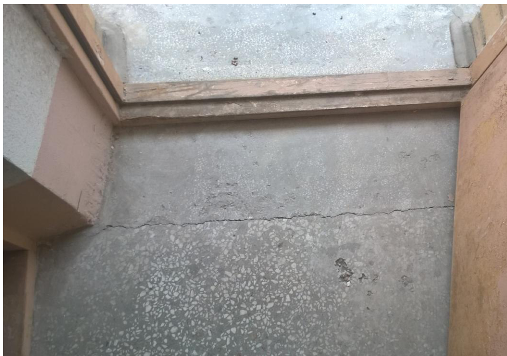
Трещина в полу у порога дверного проема на лоджию.
