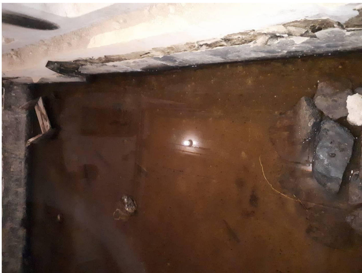
Скопление воды в помещении подвала на июнь 2018.
