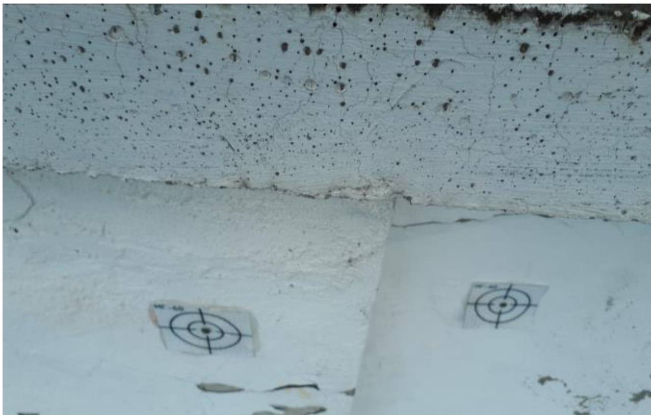
Сдвиг подъездов относительно друг друга. Сквозные трещины в кирпичной кладке стен.
