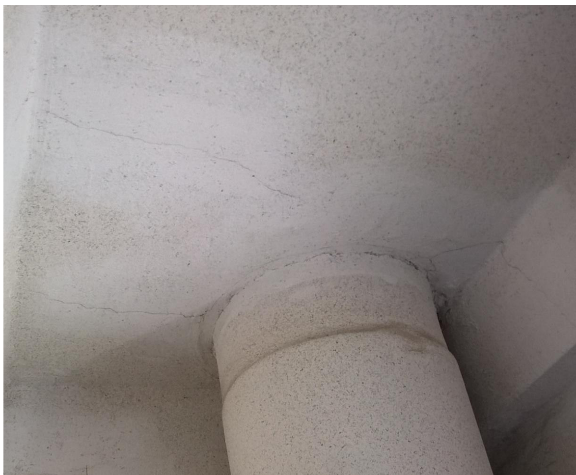
Сквозные трещины в полке плиты перекрытия в зоне прохода трубы мусоропровода.
