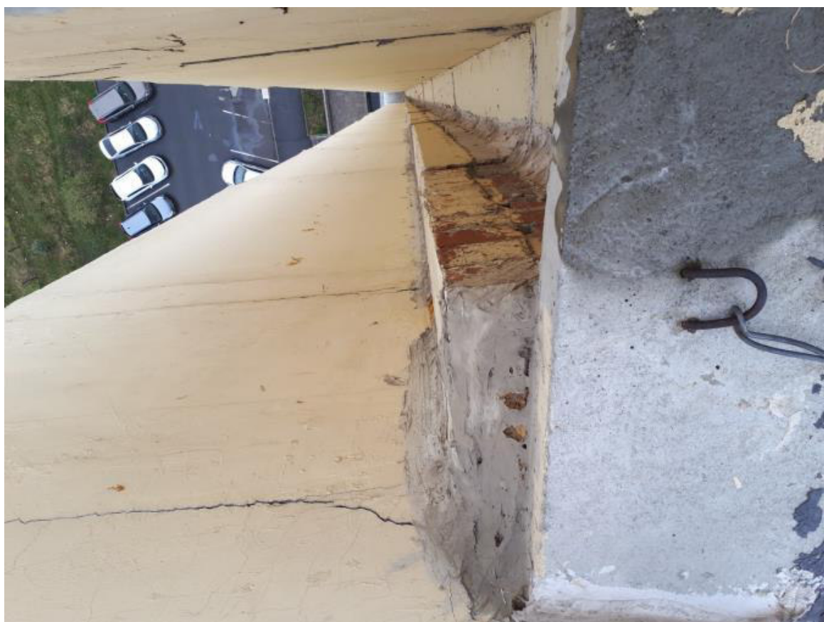
Сдвиг подъездов относительно друг друга. Сквозные трещины в узлах примыкания стеновых панелей.
