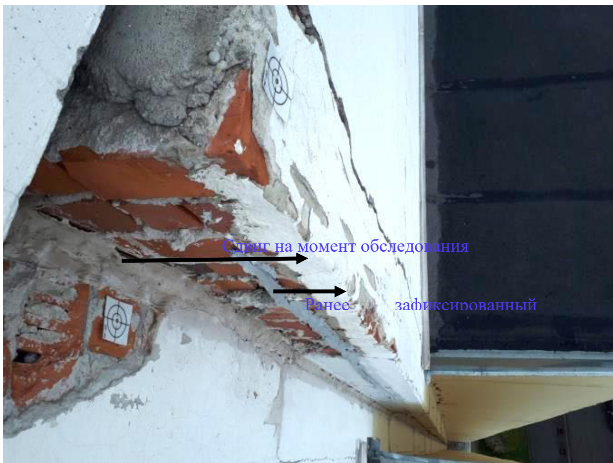
Сдвиг подъездов относительно друг друга. Сквозные трещины в кирпичной кладке стен.
