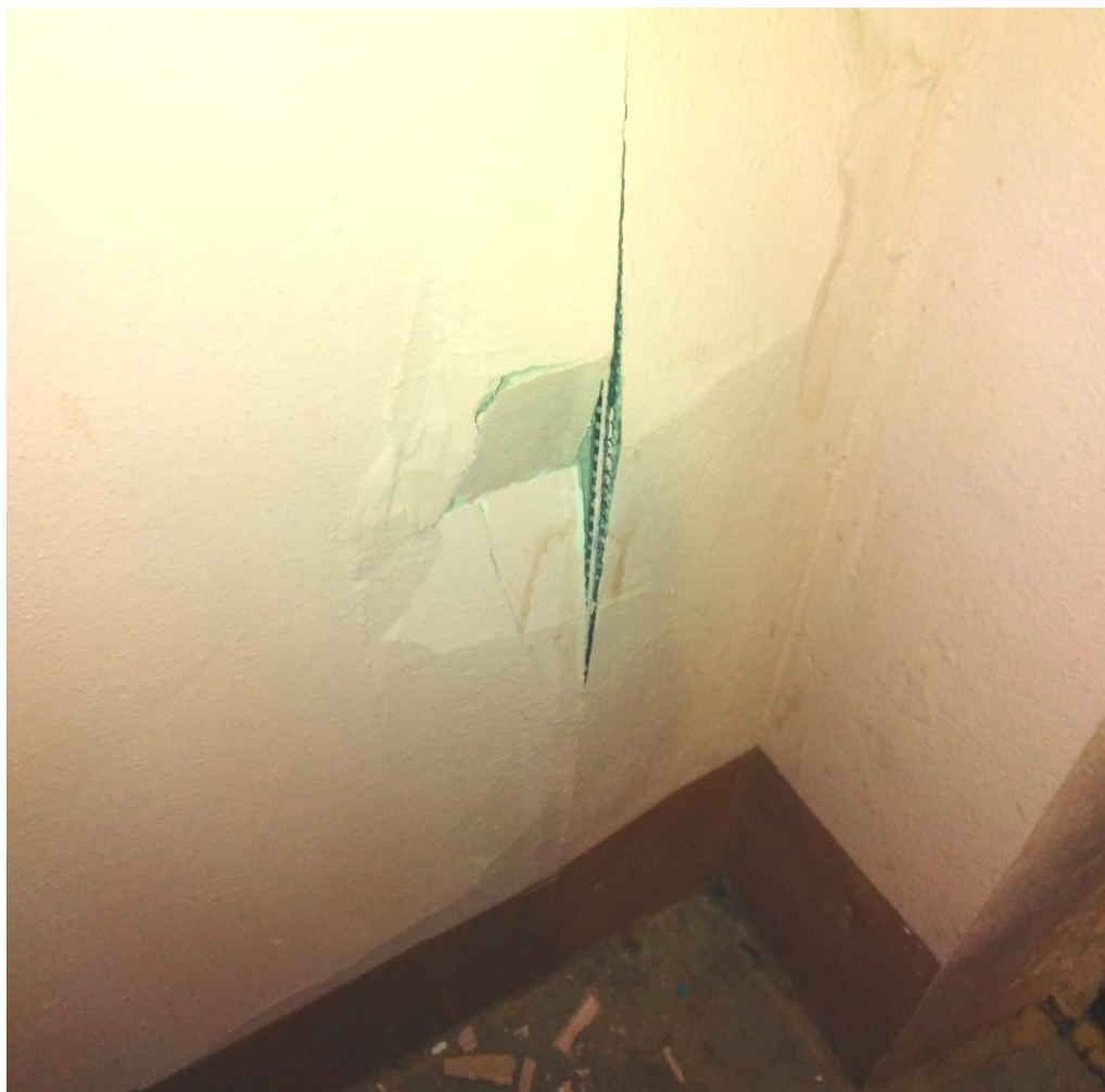
Повреждение штукатурного слоя и гипсокартона.
