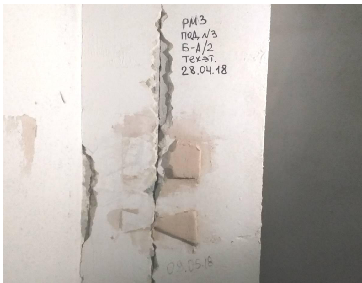
Повторное разрушение маяка РМ3 техэтажа подъезд 3 (секция 1).
