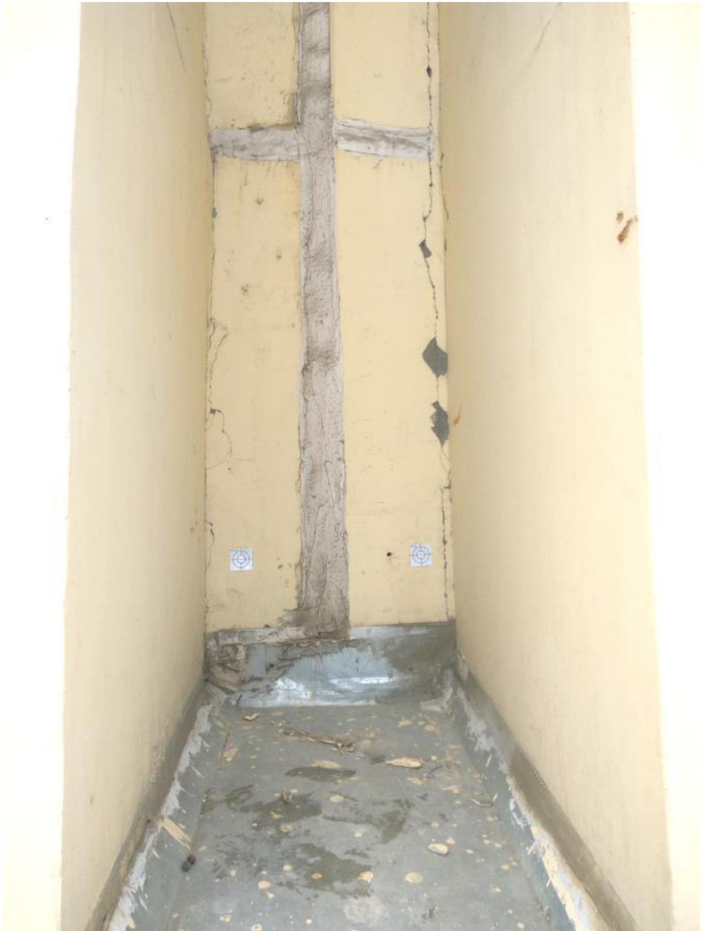
Общий вид шва между подъездами. Отклонение по высоте подъездов относительно друг друга. Трещины в узлах примыкания стеновых панелей возле шва между подъездами.
