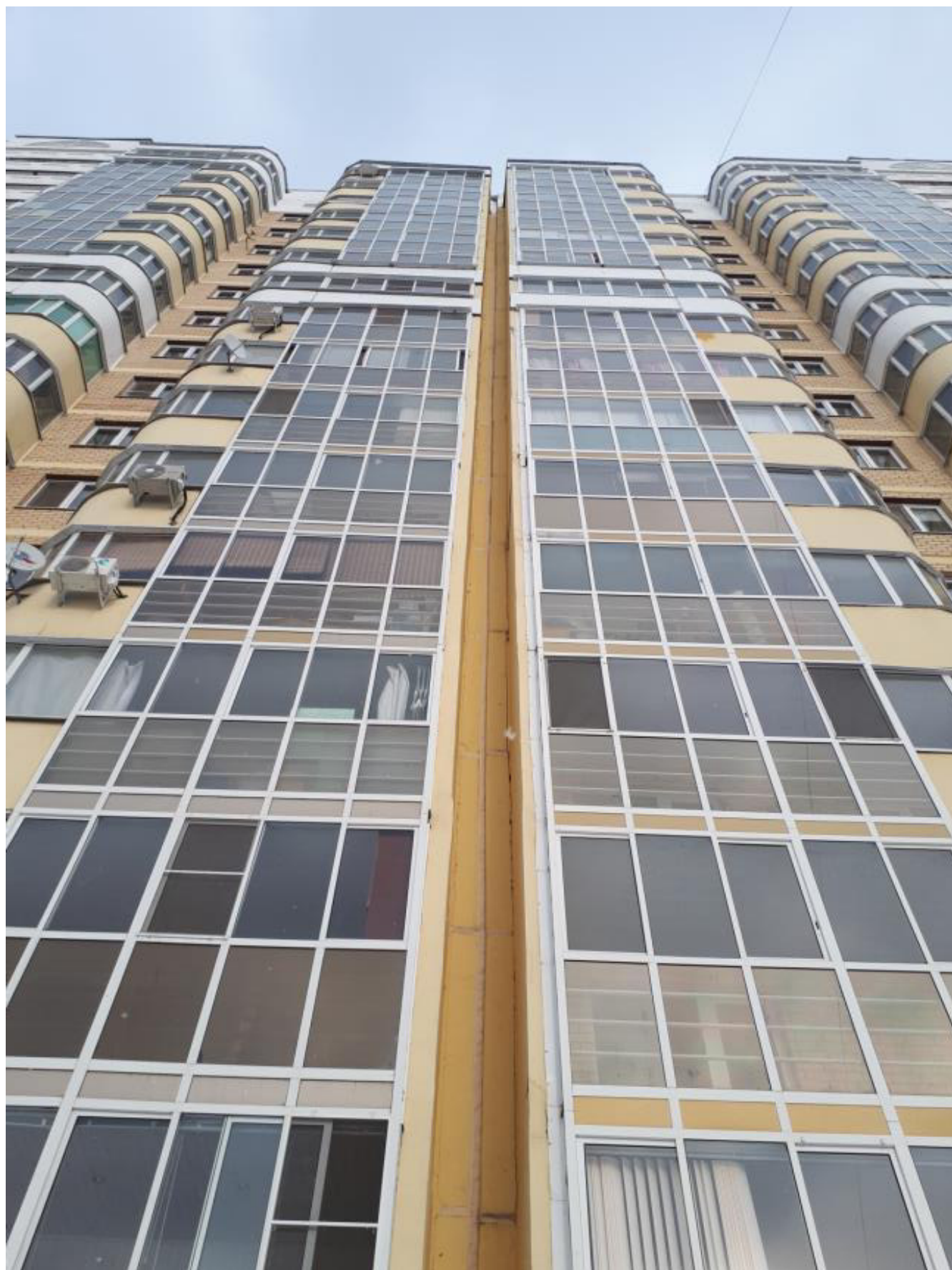
Общий вид шва между подъездами с дворовой стороны. Отклонение по высоте подъездов относительно друг друга.
