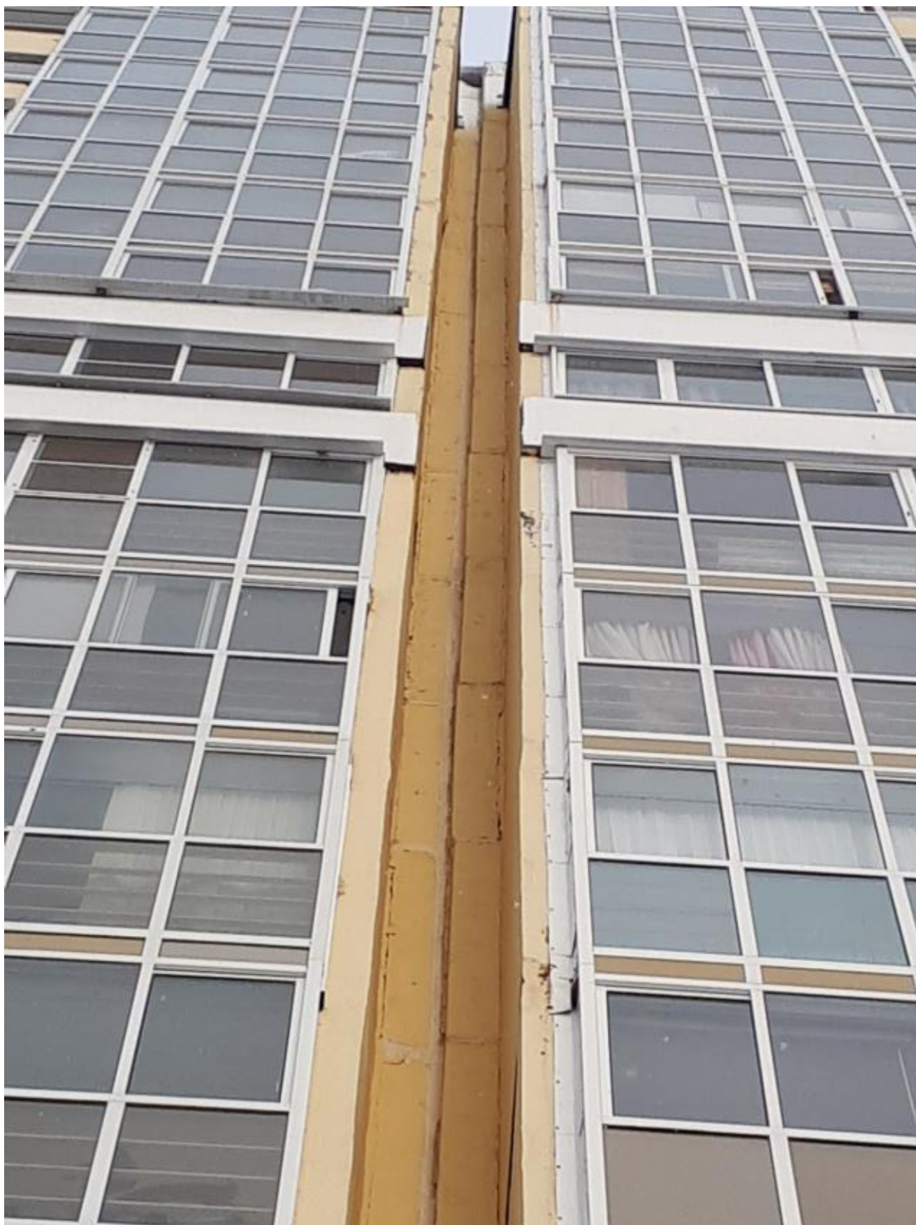
Общий вид шва между подъездами 2 и 3 с дворовой стороны. Отклонение по высоте подъездов относительно друг друга.
