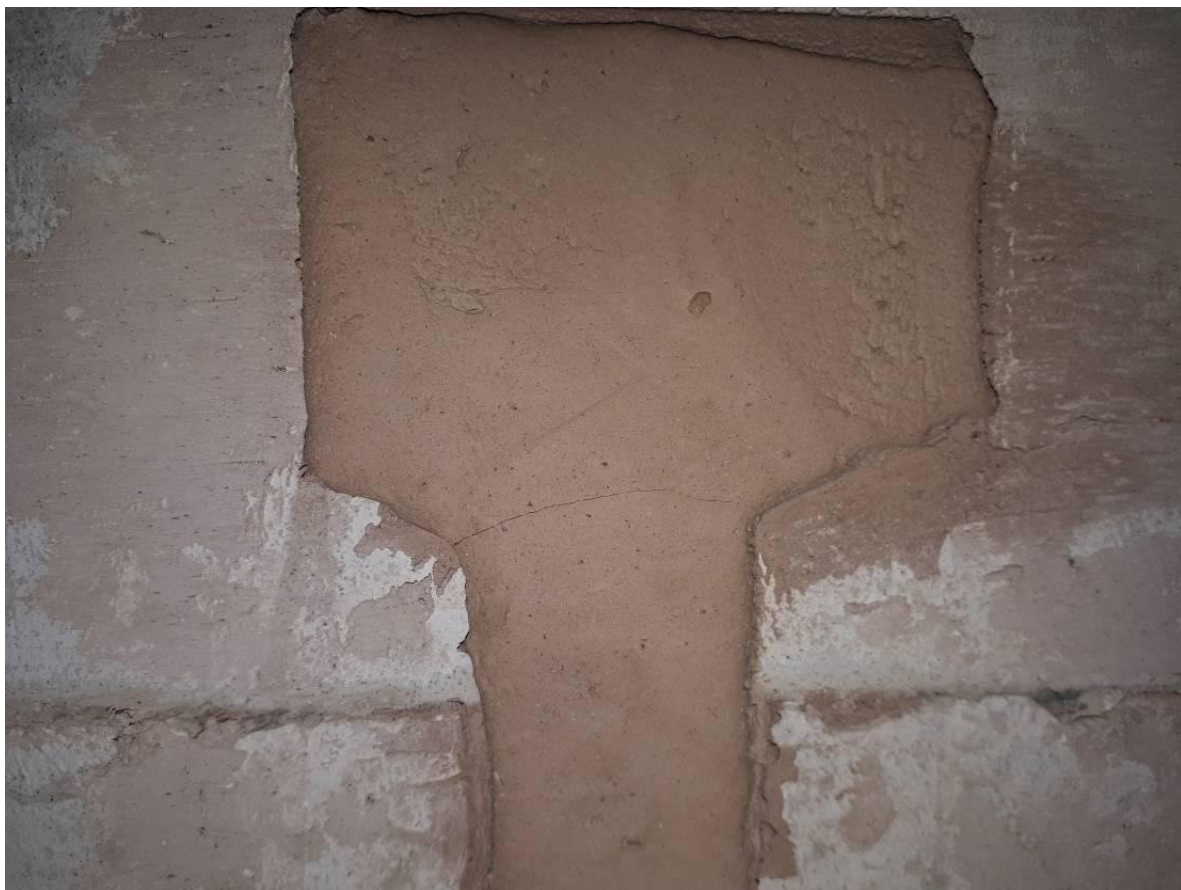
Трещина в маяке РМ2 техэтажа подъезд 3 (секция 3).
