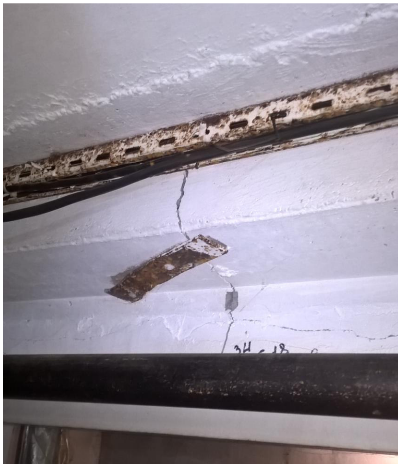
Сквозная трещина в продольном ребре перекрытия подвала.
