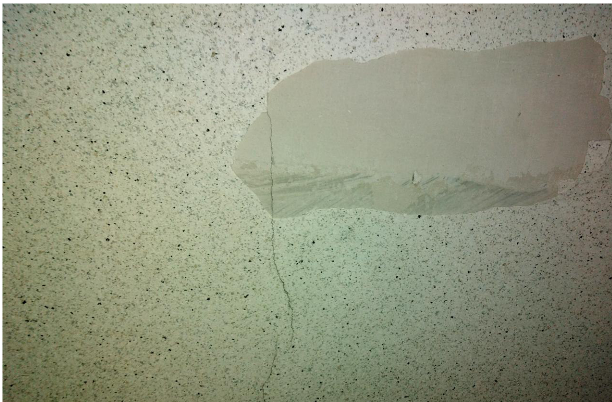
Трещина в стеновой панели лестничной клетки.
