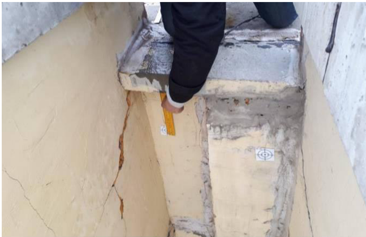
Сдвиг подъездов относительно друг друга. Сквозные трещины в узлах примыкания стеновых панелей.
