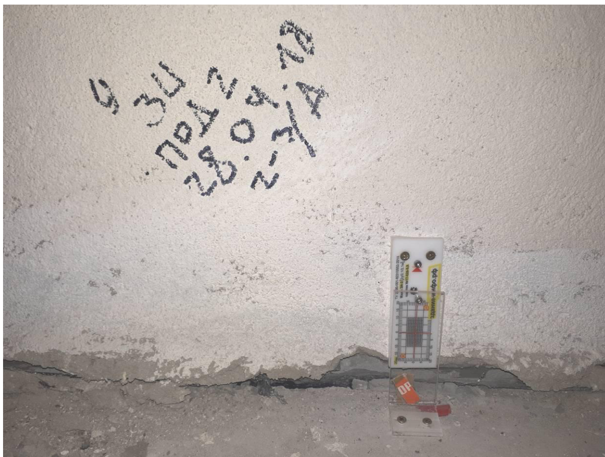
Маяк 3И9 техэтажа подъезд 2 (секция 2).
