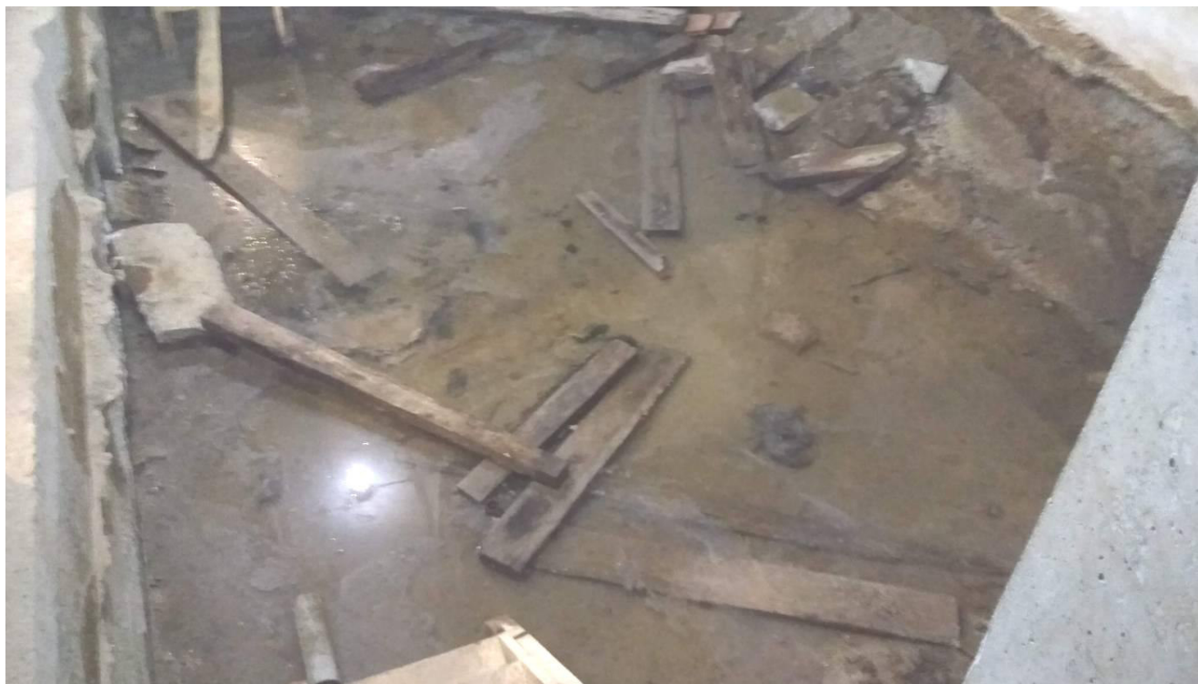
Скопление воды во всех помещениях подвала 3 подъезда (секция 1) на сентябрь 2018.
