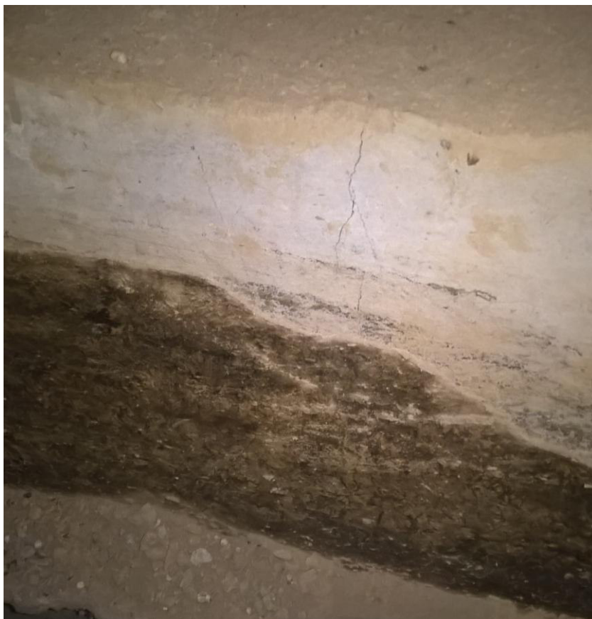
Трещина в армопоясе в помещении подвала.
