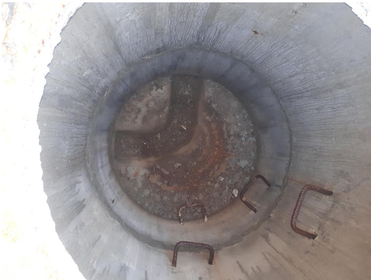
Уровень колодцев дренажной системы по периметру здания выше уровня пола подвала.
