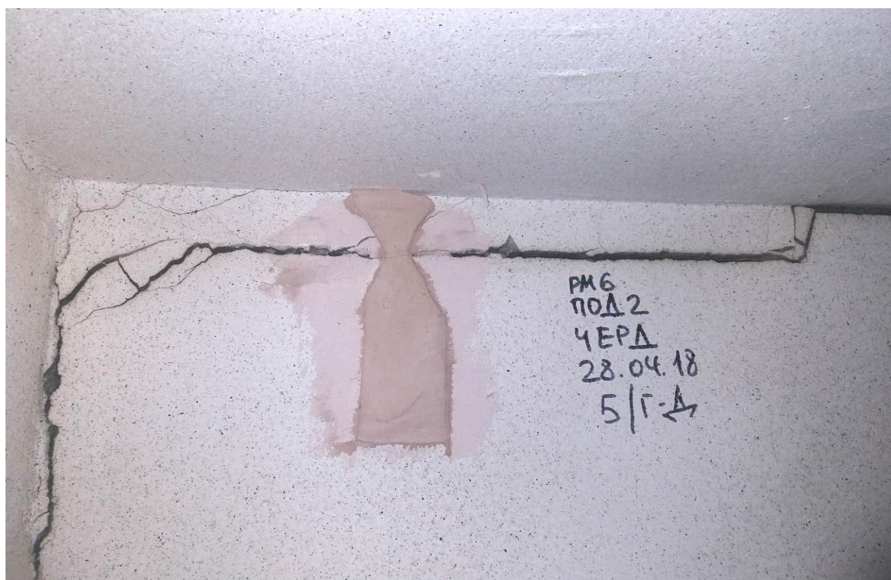
Трещина в маяке PM6 выхода на крышу подъезда 2 (секция 2).
