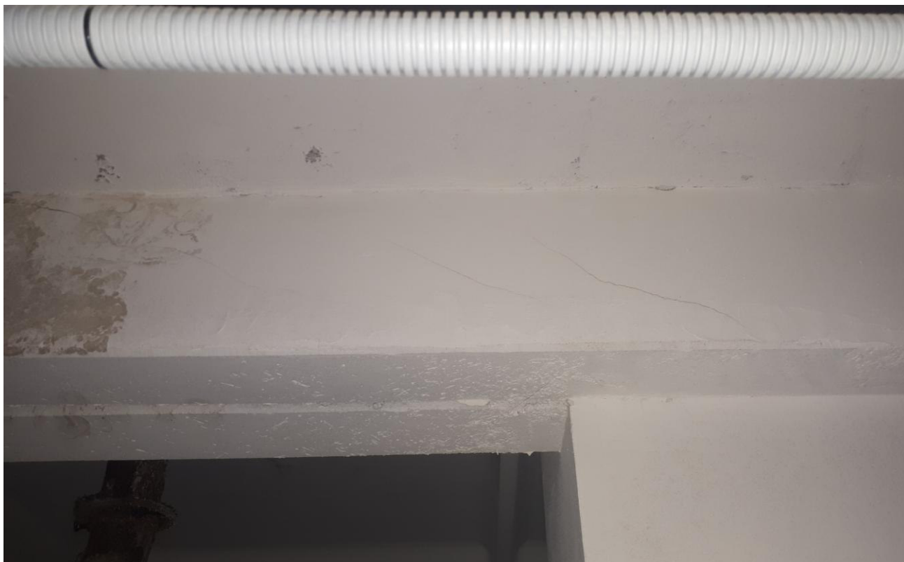
Трещины в балке покрытия техэтажа 1 подъезда образовавшиеся на январь 2021.
