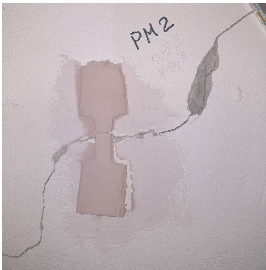
Трещина в маяке PM2 техэтажа подъезда 2 (секция 2).
