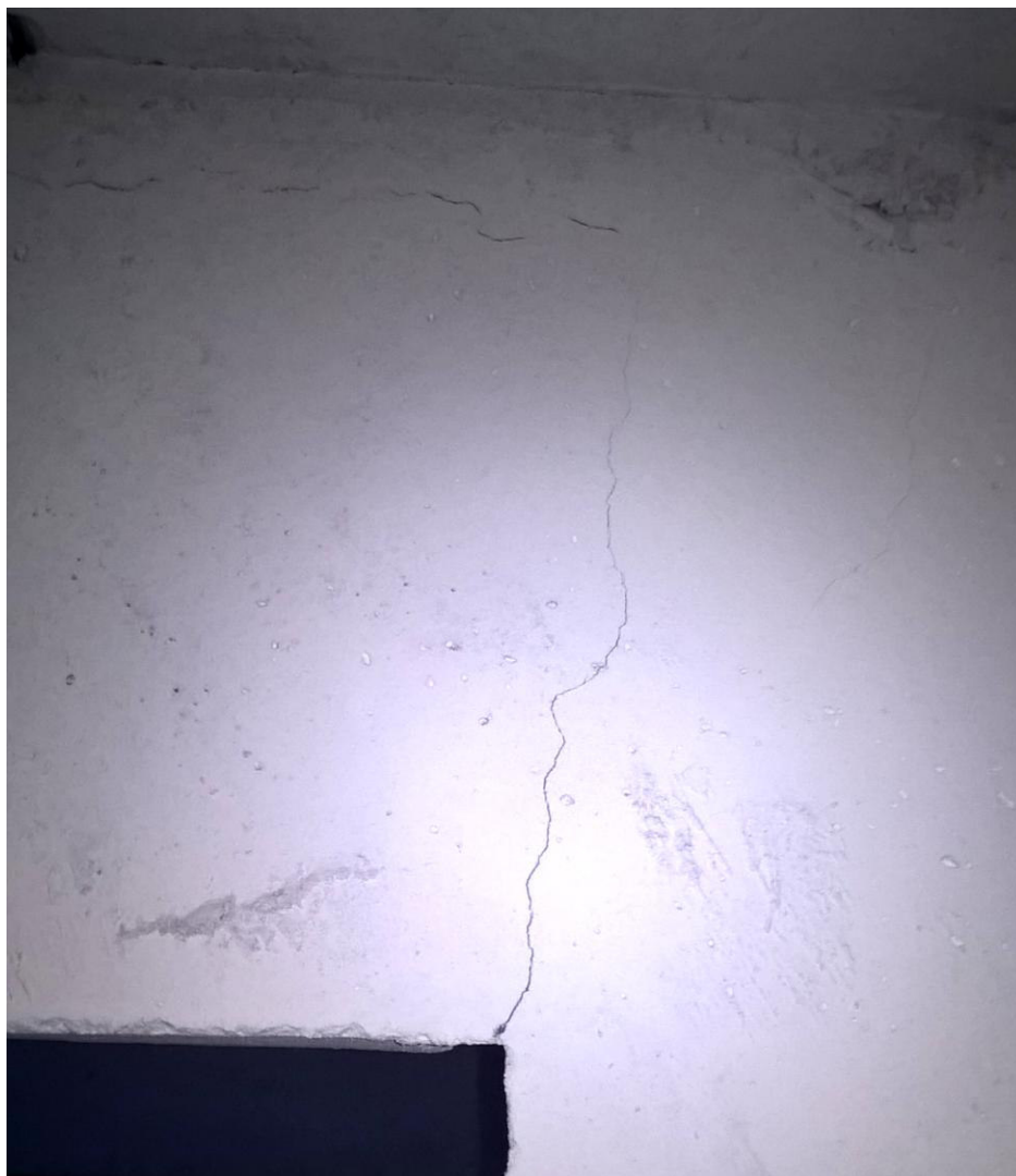
Сквозная трещина в стеновой панели образовавшаяся на январь 2021.
