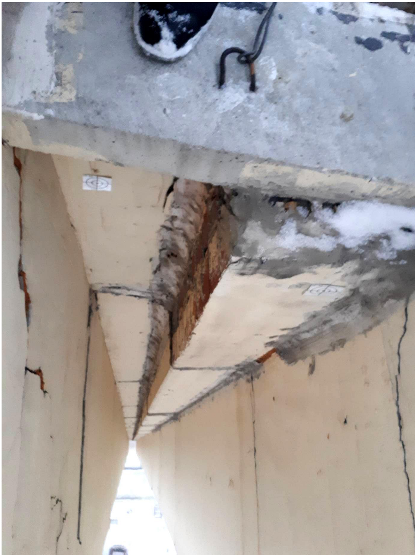
Сдвиг подъездов относительно друг друга. Сквозные трещины в кирпичной кладке стен. Состояние на январь 2021.
