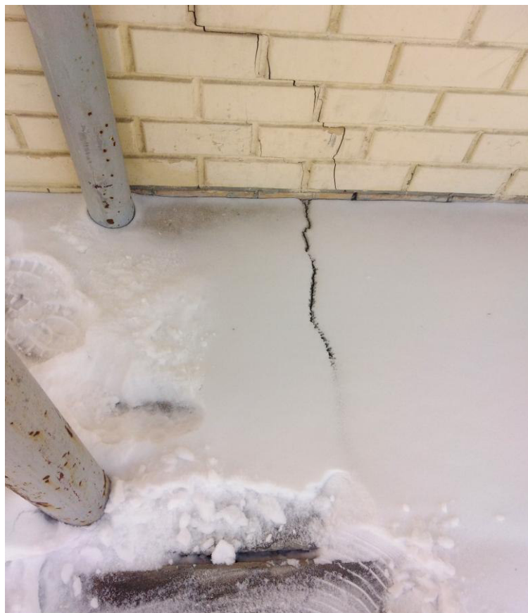
Трещина в покрытие крыльца. Образование зазора между ступенью и крыльцом.
