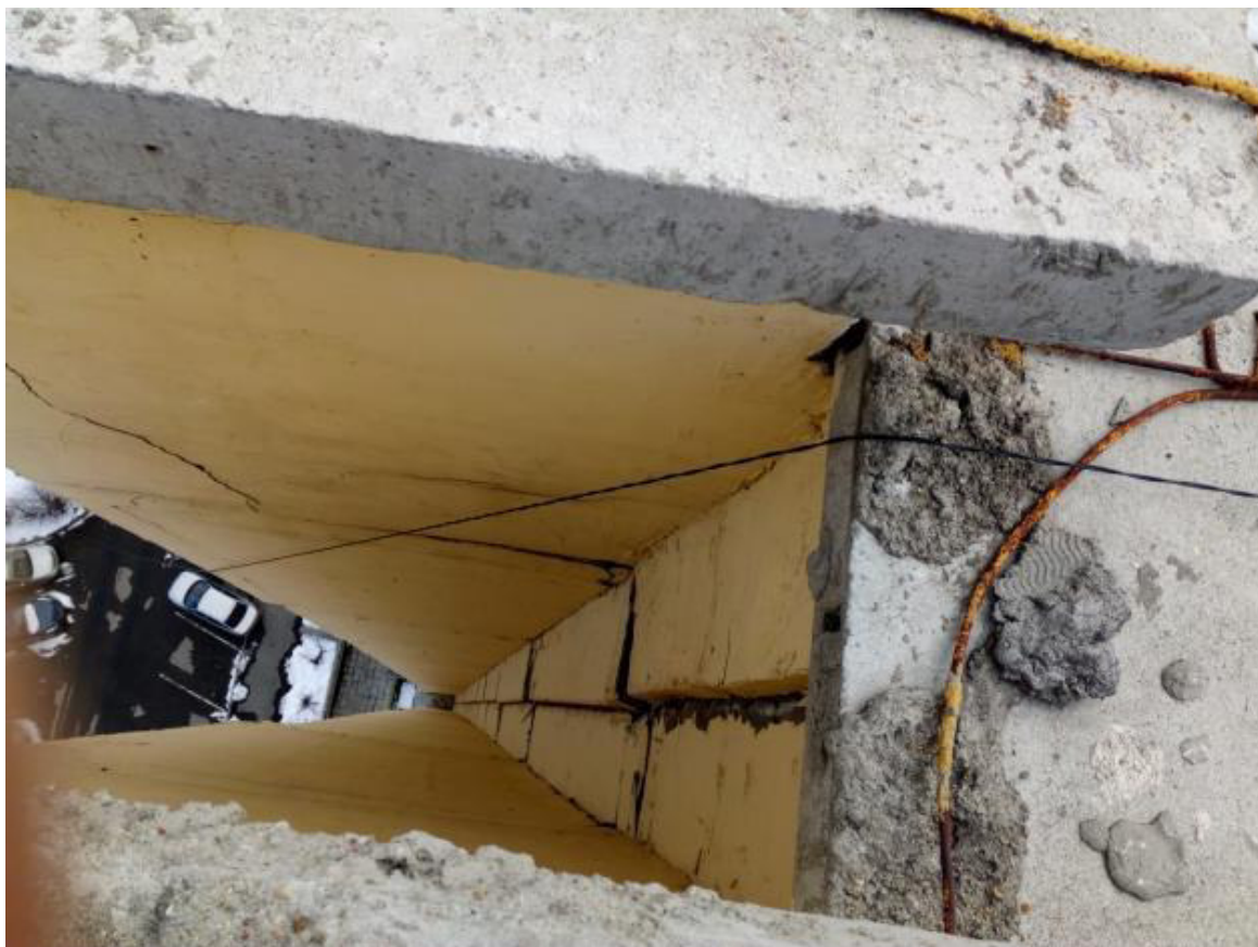
Сквозные трещины в стеновых панелях вблизи шва между подъездами. Сдвиг подъездов относительно друг друга.
