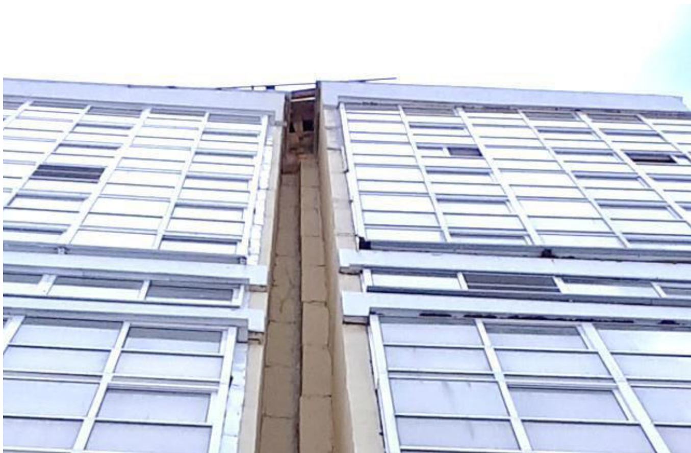
Общий вид шва между подъездами 1 и 2 с уличной стороны.
