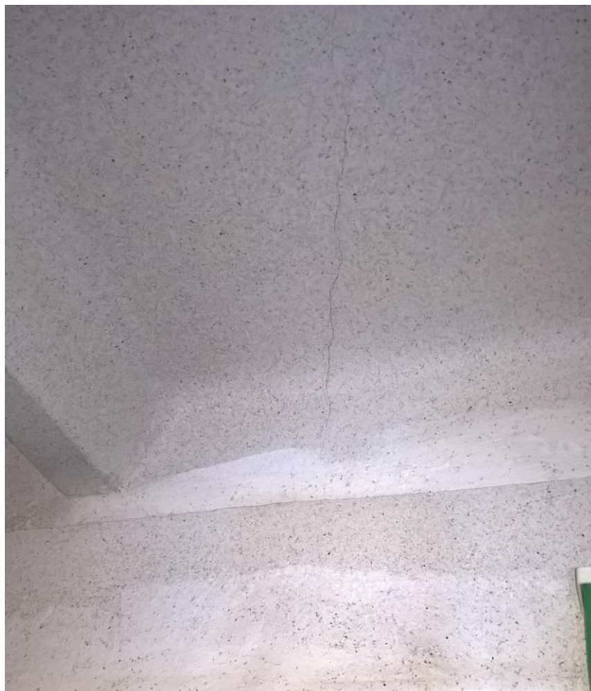
Трещина в полке плиты перекрытия с переходом в продольное ребро.
